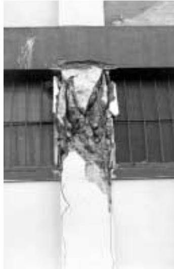
Fotografía 2-29. Falla por efecto de columna corta
