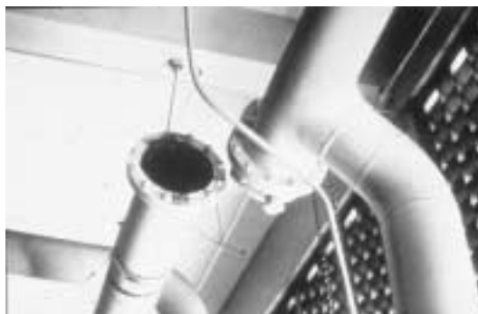
Fotografía 2-15. Daños severos en instalaciones
