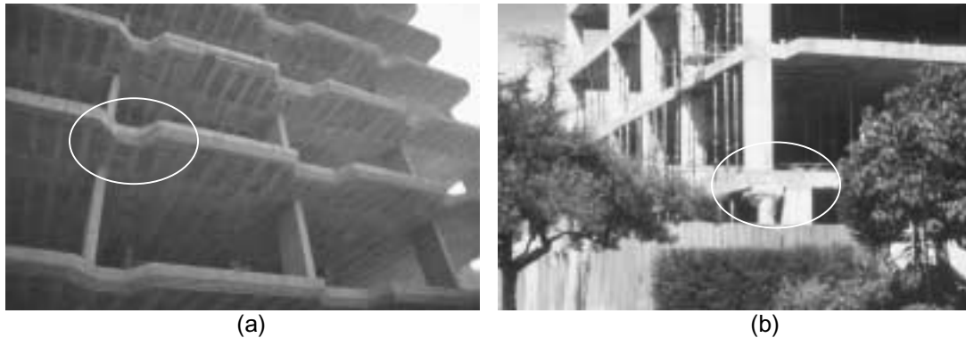
Fotografías 2-28. Fallas en la configuración estructural
