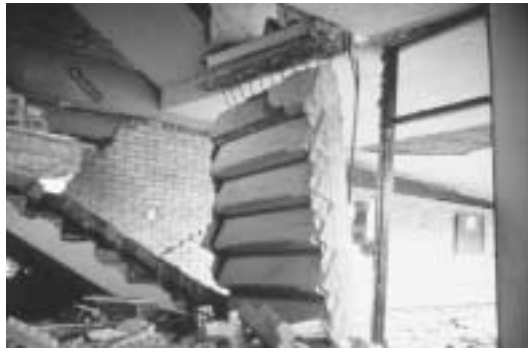
Fotografía 2-14. Daño severo en escaleras
