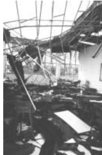
b) Daño Severo
