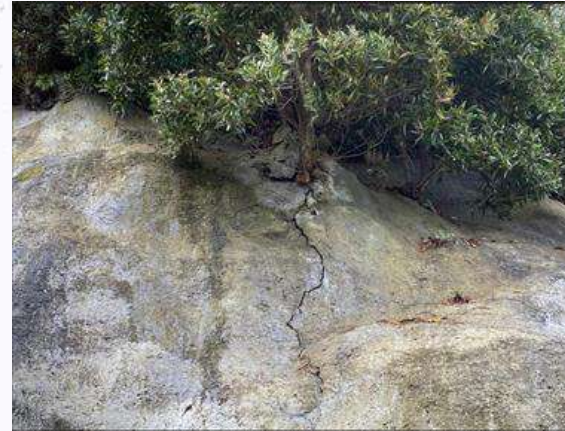
Sendero Empedrado, grietas en la intervención
