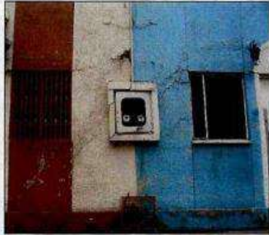
Fotografía 21 Patrón de agrietamiento en las casas de la manzana 75 en la Calle 36G Sur
