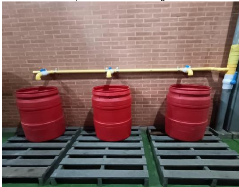
Figura 42 Sistema de aprovechamiento de agua lluvia Sede Fontibón
