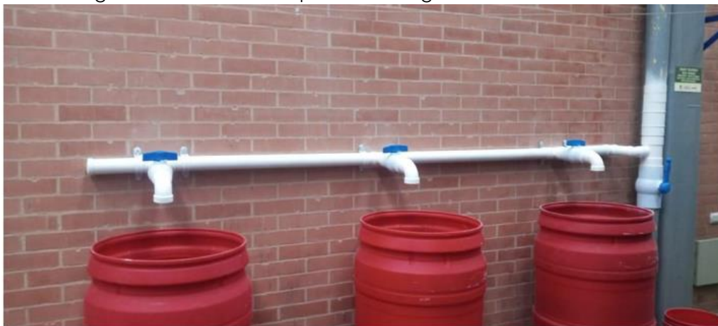
Figura 41 Sistema de captación de agua lluvia Sede Fontibón
