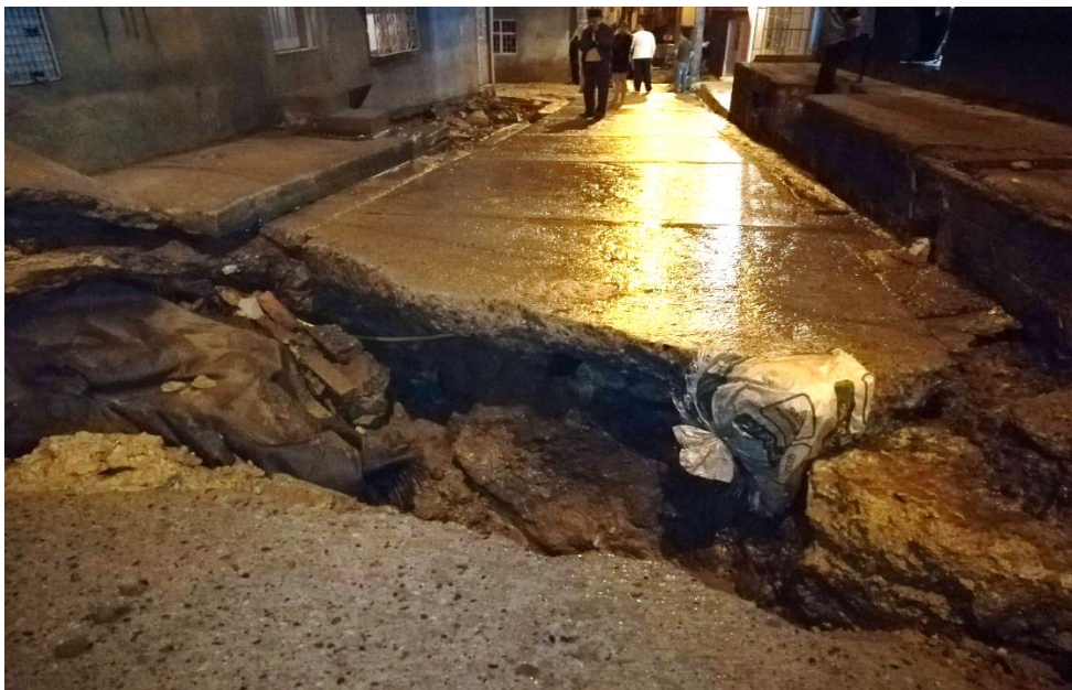
Foto No. 1 y 2 – Evento SIRE 5231052 – Daño en redes de alcantarillado, Localidad de San Cristóbal – Las Guacamayas, 17 de Noviembre de 2018
