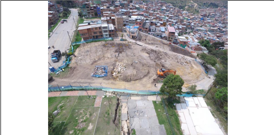
Ilustración 2 Fotografías Peñón del Cortijo (deslizamiento activo)
