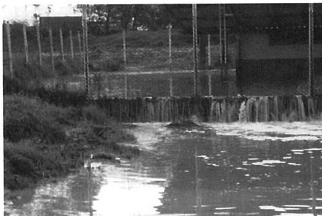
Foto 10. Estación elevadora Fontibón Inundada
