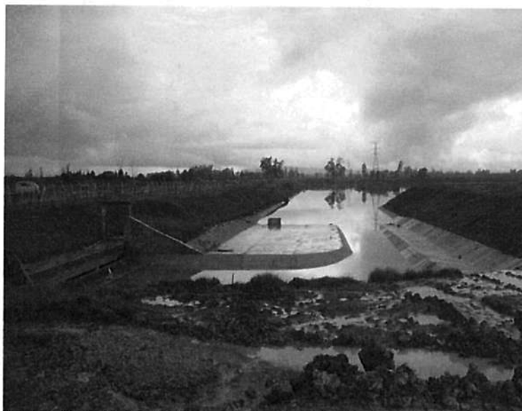
Foto 12. Pondaje la Magdalena. Niveles inferiores a los vistos el 24 de noviembre producto del bombeo realizado al canal Cundinamarca
