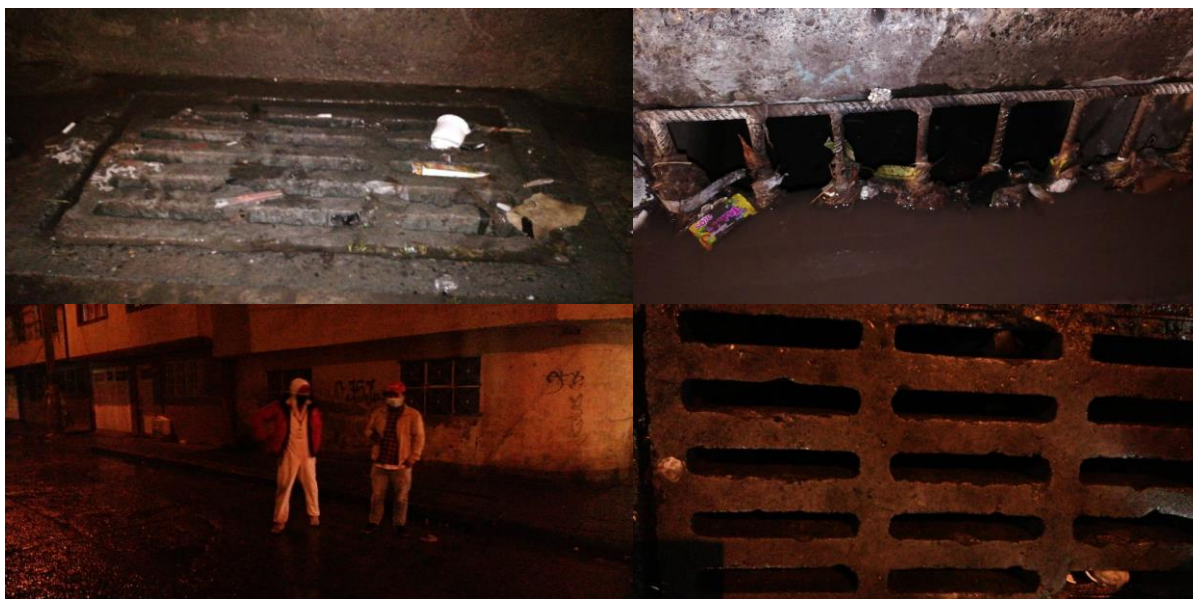
IMAGEN 1: Estado de los sumideros durante visita de verificación, sector la Batea Lucero bajo- AGAR CC - 20 de septiembre de 2020
