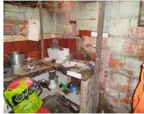
Foto No. 4. Grietas en muros perimetrales vivienda 2
