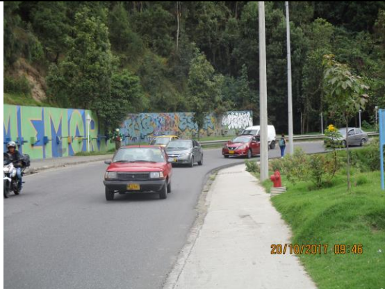
Muro Construido en el talud superior del par vial de la Avenida Circunvalar
