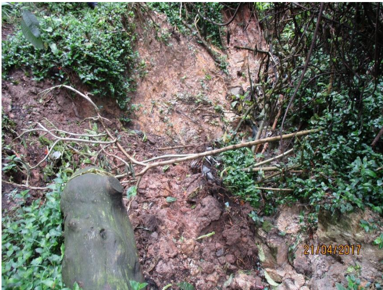
Deslizamiento del talud al cauce de la quebrada
