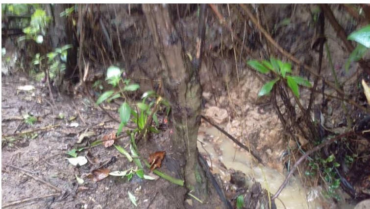
Deslizamiento de la margen del cauce de la quebrada
