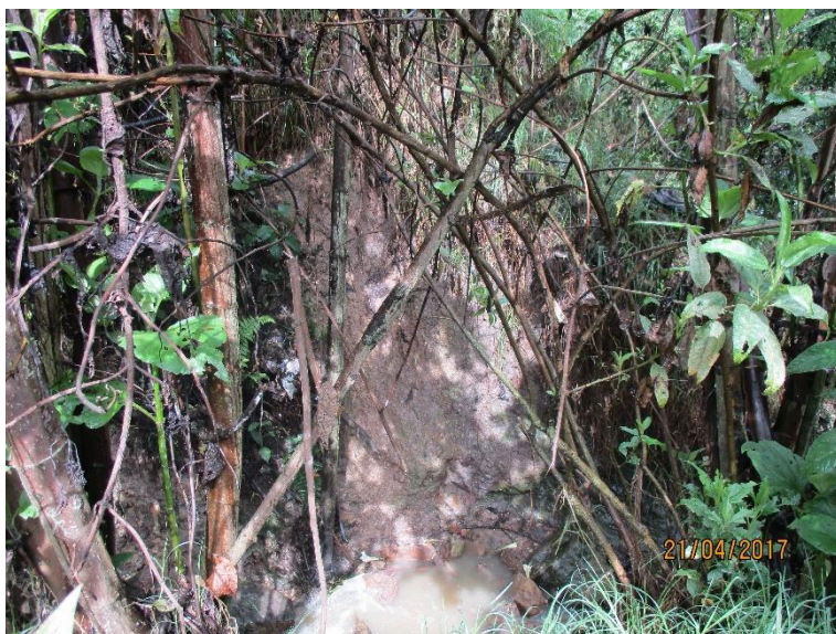
Talud del cauce que cae al lecho de la quebrada
