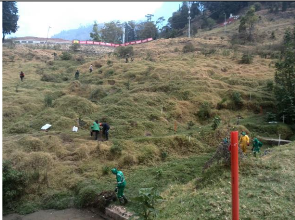
Siembra de especies nativas en el talud y Muro en piedra y malla de gallinero (parte superior derecha)
