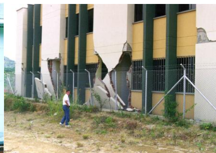
d. Daño severo
