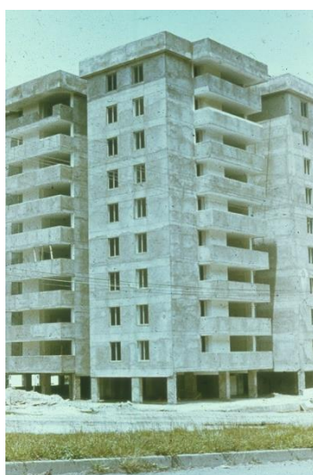
b. Piso débil en la primera planta
