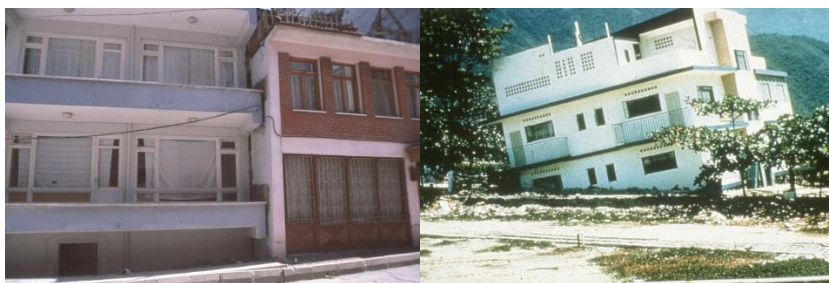
Fotografía 11. Asentamiento y licuación del suelo
