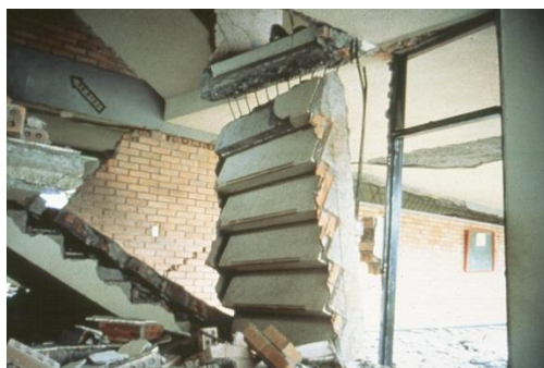
Fotografía 20. Daño severo en escaleras
