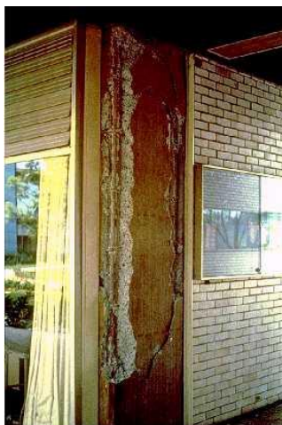
d. Daño fuerte en columna
