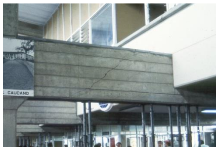
b. Daño leve en viga
