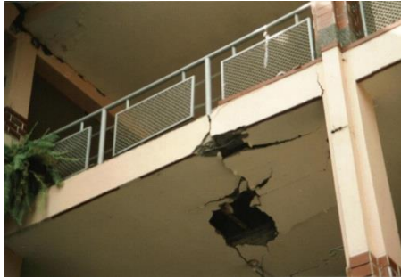
a. Daño severo
