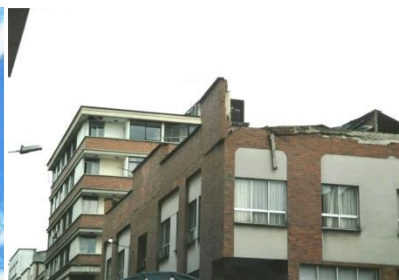
b. Daño severo
