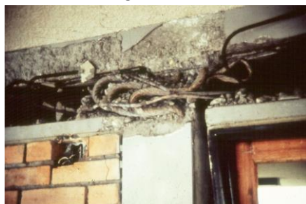
c. Daño severo en nudo
