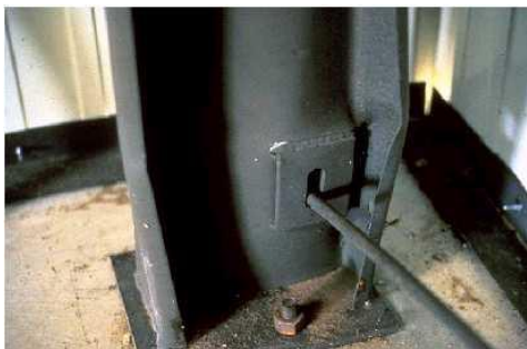
a. Daño fuerte
