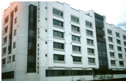
a. Daño leve
