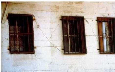
a. Daño leve
