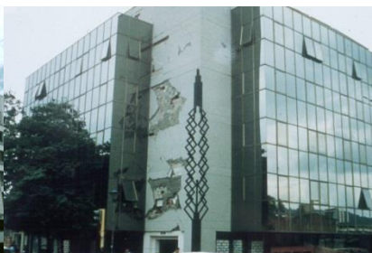
b. Daño moderado
