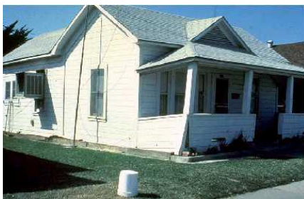
a. Daño fuerte
