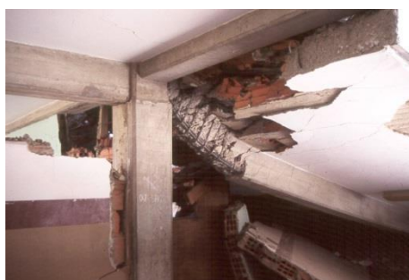
e. Daño severo en viga
