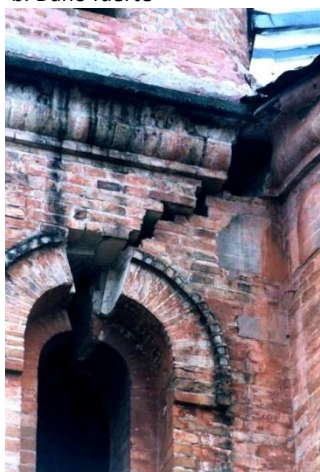
d. Daño severo
