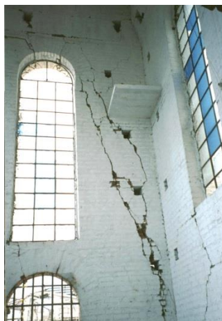
b. Daño fuerte
