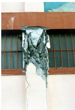
Fotografía 33. Falla por efecto de columna corta
