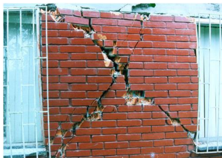
c. Daño fuerte
