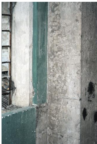
a. Daño leve en columna
