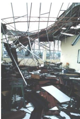
Fotografía 19. Daños en el sistema de cubierta
