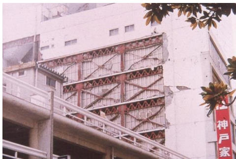
c. Daño fuerte
