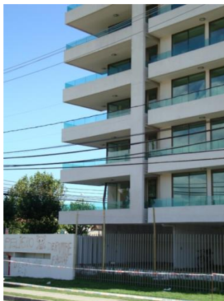
Fotografía 17. Evidencia de daño moderado en balcón del segundo piso
