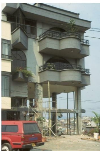
a. Piso débil con doble altura.
