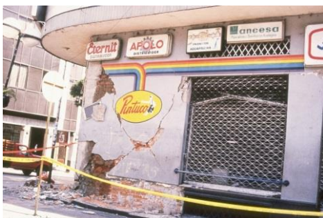
c. Daño fuerte
