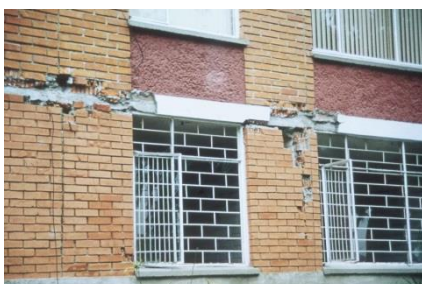
e. Daño fuerte
