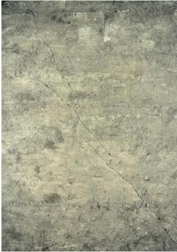
a. Daño leve
