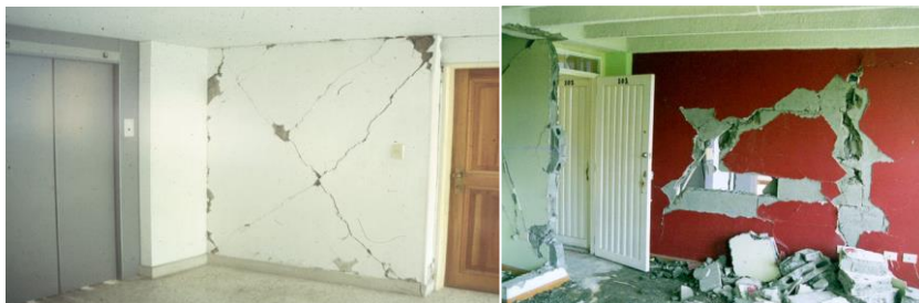
a. Daño moderado
