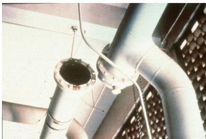
Fotografía 21. Daños severos en instalaciones
