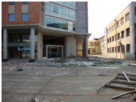
Fotografía 14. Evidencia de daño moderado en vidrios exteriores
