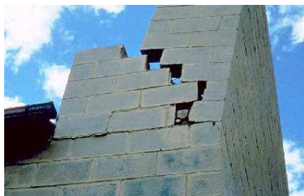
a. Daño severo
